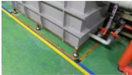
洗浄剤タンク周辺
