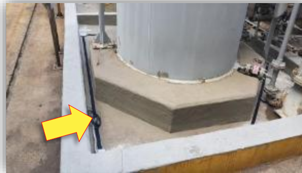
屋外化学物 貯槽タンク
