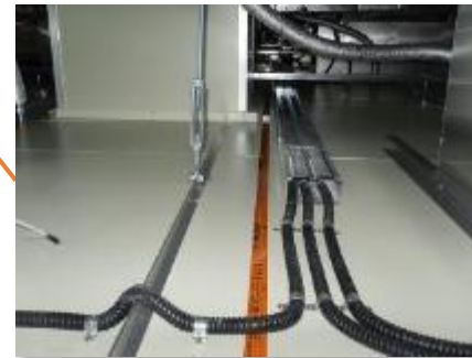
配線、配管周り
