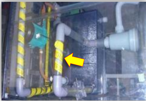
集水設備内配管
