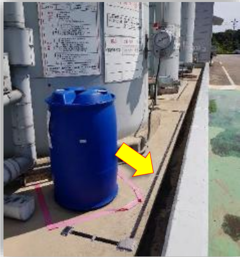
屋外の有害化学物質の 貯蔵タンク
