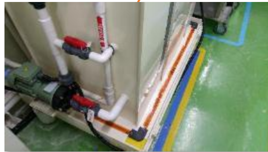
化学溶剤パイプ、貯槽タンク
