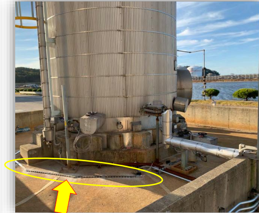
海岸に隣接した場所の 貯蔵タンク
