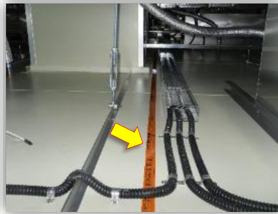
室内サーバー・電源・ 恒温恒湿機器の周辺設置
