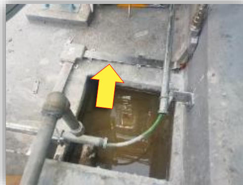
屋外化学 集水施設
